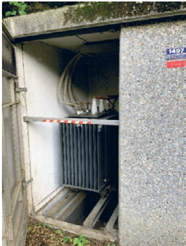
Trafostation «Länge» mit altem Trafo
